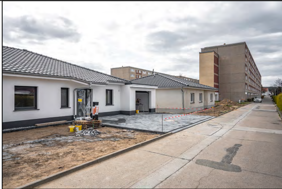
Eisenhüttenstadt, neu errichtete Einfamilienhäuser; im Hintergrund zum Abbruch vorgesehene Wohnhäuser in Plattenbauweise, 2021 Foto: Martin Maleschka © Martin Maleschka
